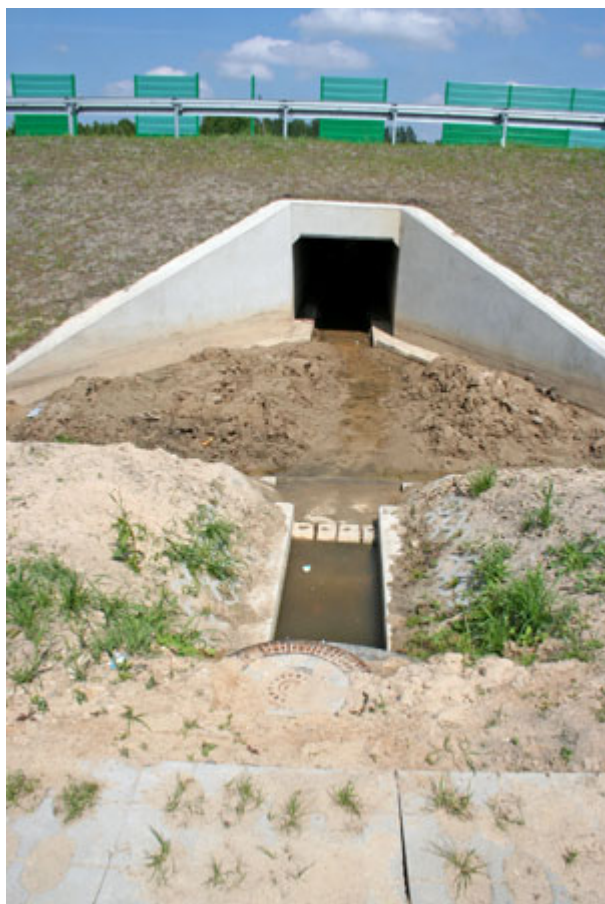
Studnia wpadowa na wprost wyjścia z przepustu. Fot. Radosław Ślusarczyk
